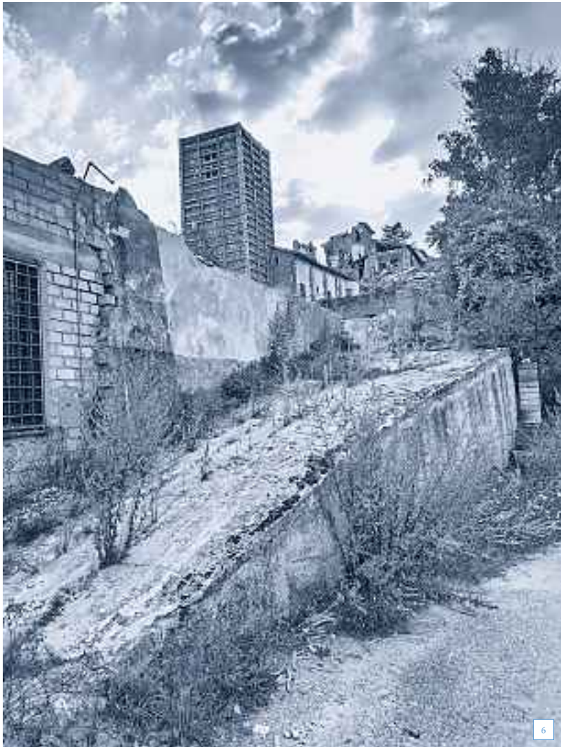
6 Der statisch gesicherte Palazzo del Podestà in der militärisch bewachten roten Zone von Accumoli. Foto: © Renate Prünster-Deschauer.
